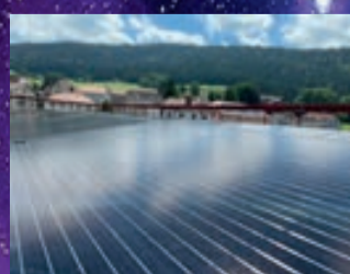
Installation photovoltaïque Communauté d'autoconsommation
