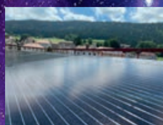
Installation photovoltaïque Communauté d'autoconsommation
