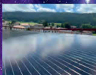
Installation photovoltaïque Communauté d'autoconsommation
